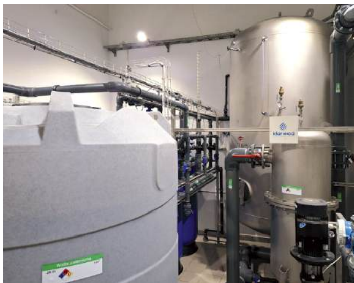
Fot.3. Przykład stacja uzdatniania wody przeznaczona do produkcji spożywczej suchej.
