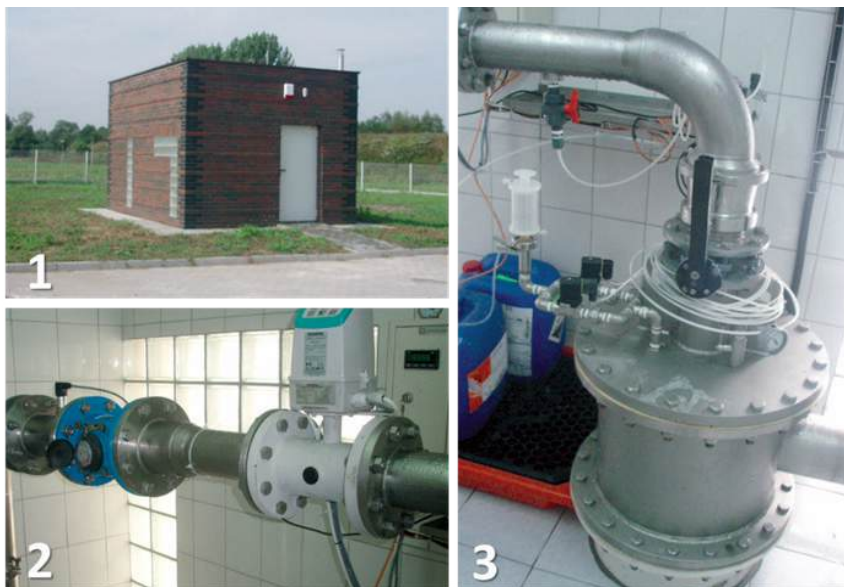
Fot. 1. Pobór wody z pokładów podziemnych: 1 – budynek zadaszony (well house), 2 – przepływomierz wody surowej, 3 – głowica studni z instalacją chlorowania wstępnego wody surowej. Źródło: fotografie ze zbiorów autora.
