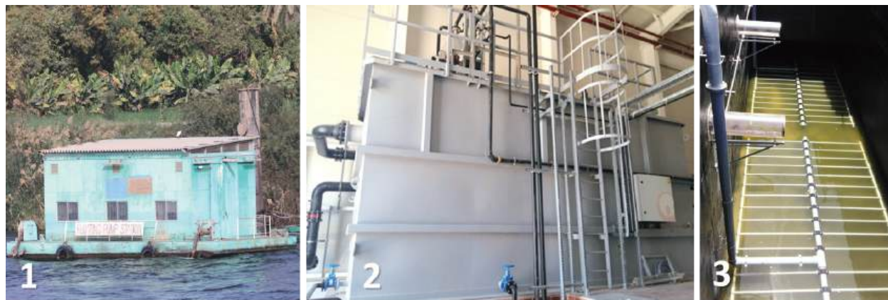
Fot. 2. Pobór wody z zasobów powierzchniowych i jej uzdatnianie: 1 – pobór wody z układem pompowym zasysającym wodę surową z zasobów powierzchniowych (floating pump station), 2 – widok reaktora uzdatniania wstępnego wody powierzchniowej, 3 – widok do wnętrza reaktora uzdatniania wstępnego wody powierzchniowej typu Actiflo®, widoczny system lameli. Źródło: fotografie ze zbiorów autora.
