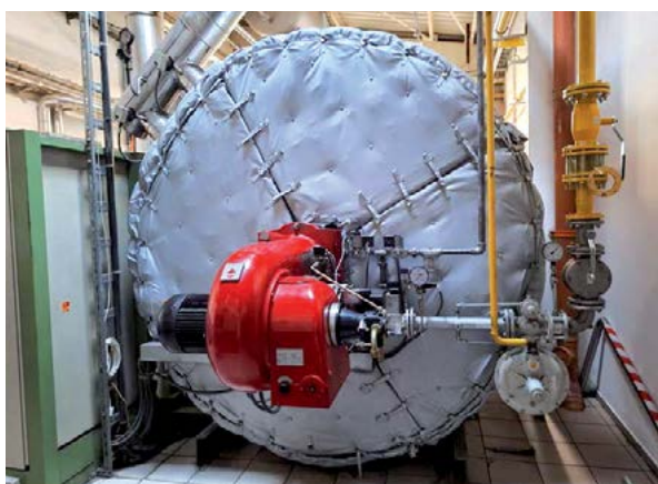
Fot. 9 i Fot. 10. Izolacje frontu kotła dedykowanego do wytwarzania medium grzejącego instalacje procesowe oraz izolacja armatury znajdującej się na rurociągu przesyłowym tego medium. Źródło: fotografie ze zbiorów autora.
