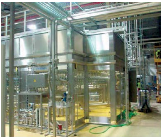
Fot.15 i Fot. 16. Przykłady właściwego ekranowania urządzeń i maszyn w przemyśle spożywczym- rozlewniczym z uwzględnieniem zapewniania higieny takich rozwiązań (łatwego ich mycia). Źródło: fotografie ze zbiorów autora.
